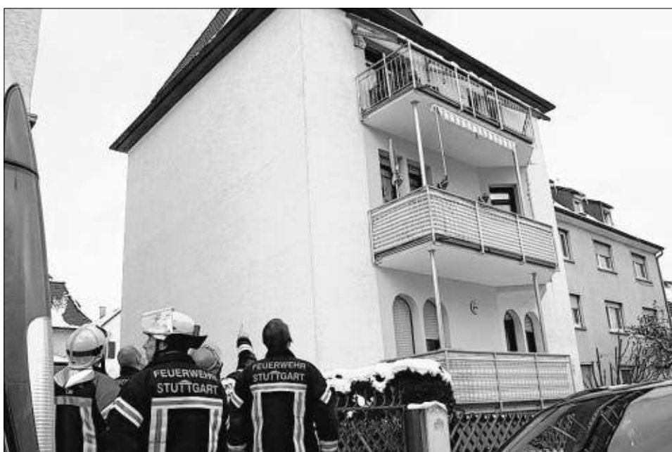
Die Feuerwehr rückte wegen einer einsturzgefährdeten Balkonüberdachung an. Foto: Friedel
